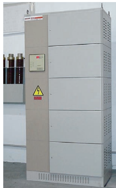
< Zainstalowana w rozdzielni bateria kondensatorów ze sterownikiem.
