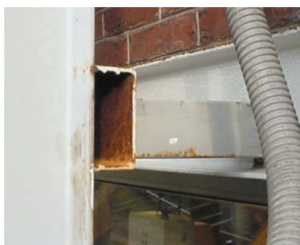
^ Korozja elementu wklęsłego niezabezpieczonego.
