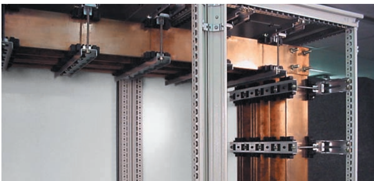
< Zestaw szyn zasilających 4000 A w obudowie Altis.
