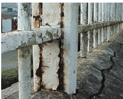
^ Korozja spowodowana retencją pomiędzy złączonymi i nieuszczelnionymi elementami.
