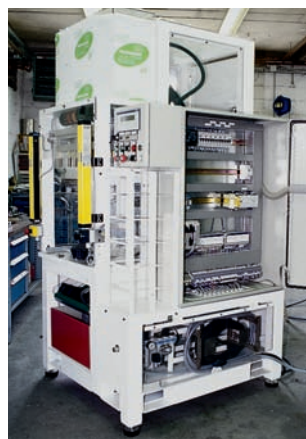
^ Rozdzielnica Atlantic zamontowana na stojaku w maszynie drukarskiej.
