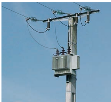
< Stacja transformatorowa na słupie elektrycznym.
