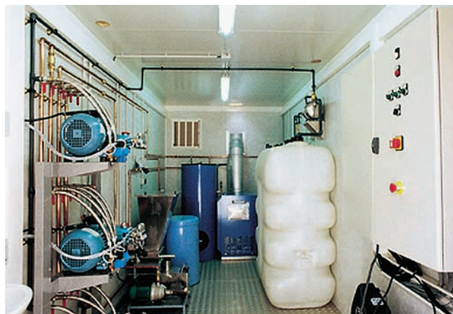
^ Szafki Atlantic do sterowania stacją oczyszczania ścieków.
