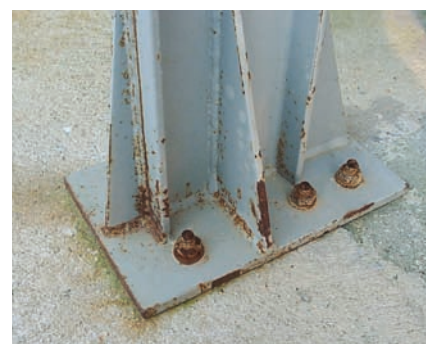
^ Ostre krawędzie i sworznie są częstym siedliskiem korozji.
