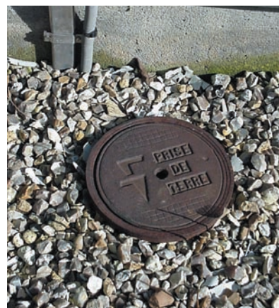
^ Uziemienie instalacji odgromowej.
