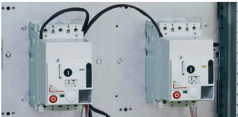
< Wyłączniki DPX 250 zamontowane w układzie SZR, wyposażone w napędy silnikowe.
